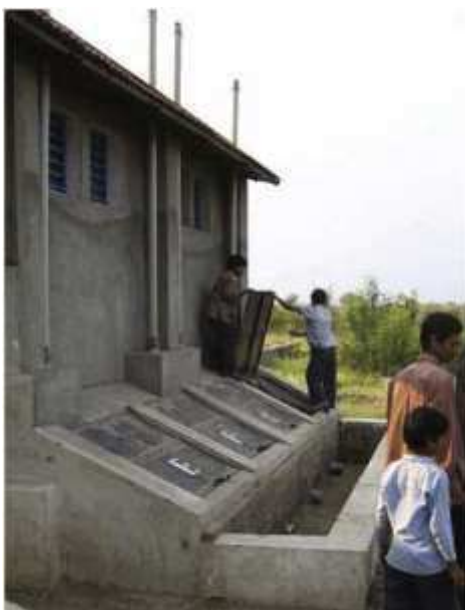
Figura 5 – Câmara de desidratação de fezes integrada ao banheiro.
