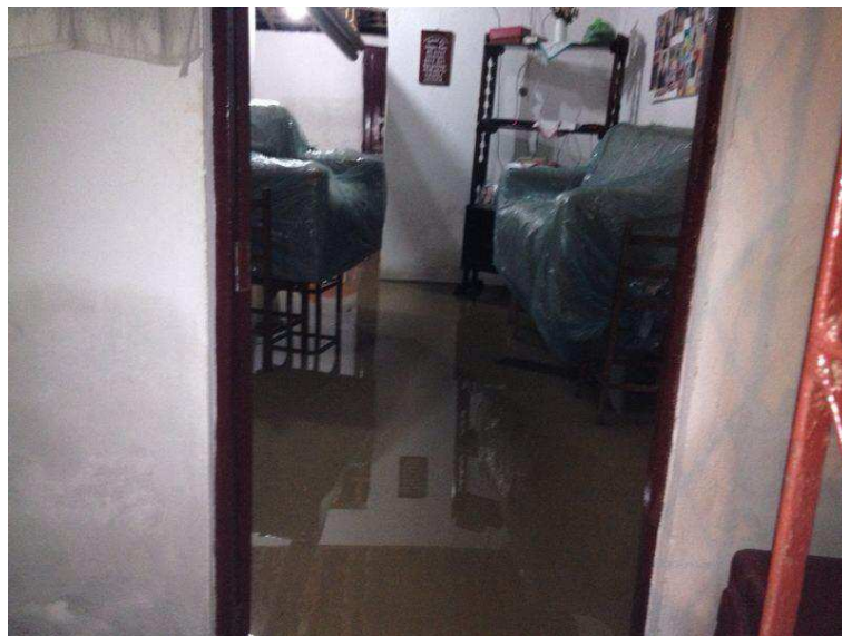
Figura 31 - Interior de residência após episódio de chuva
