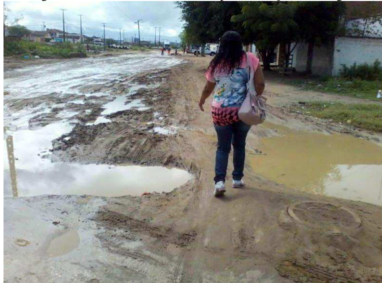
Figura 38 - Avenida de acesso sem pavimentação e drenagem
