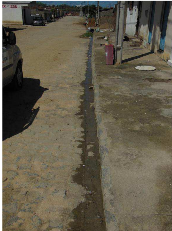
Figura 30 - Presença de esgoto na sarjeta
