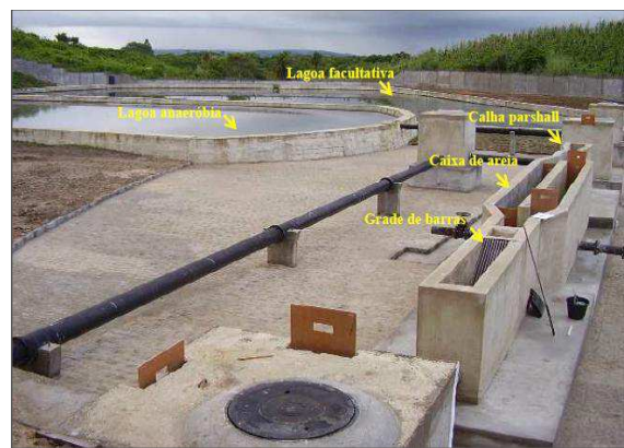
Figura 4.5 - Vista das unidades do sistema de tratamento.
