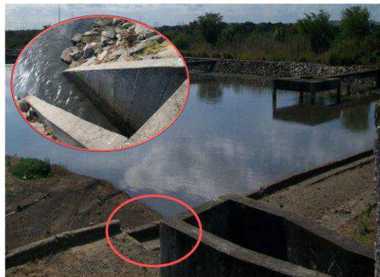
Figura 4.8 – Ponto P2 - Calha Parshall da ETE de Campina Grande, Catingueira.
