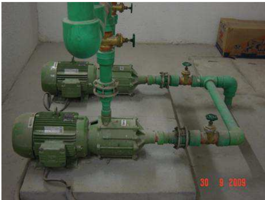
Figura 2.2 – Bombas de recalque do sistema predial de abastecimento
