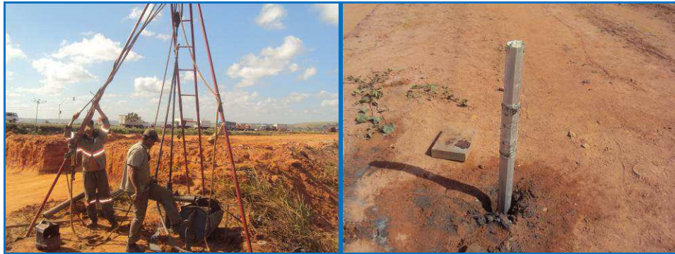
Figura 3.23 - Implantação dos inclinômetros.
