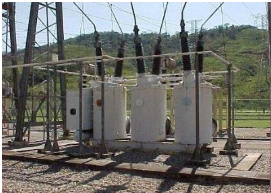
Figura 8 - Disjuntor a óleo de alta tensão
