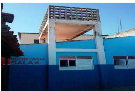
Figura 6. Caixa elevada da escola Antonio Meira
