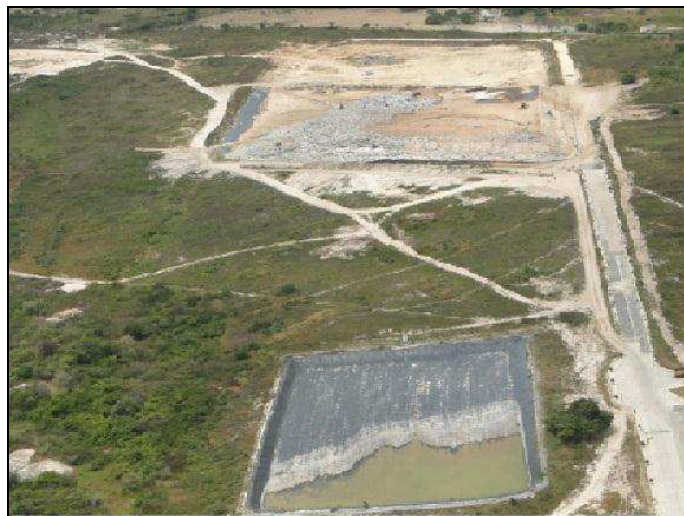
Figura 13 - Aterro sanitário sem cerca viva nas áreas limítrofes.
