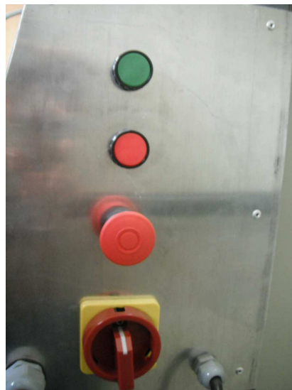
Figura A.4: Chaves de acionamento da plataforma, de cima para baixo: Liga, Desliga, Desliga(Emergência) e Liga o trifásico
