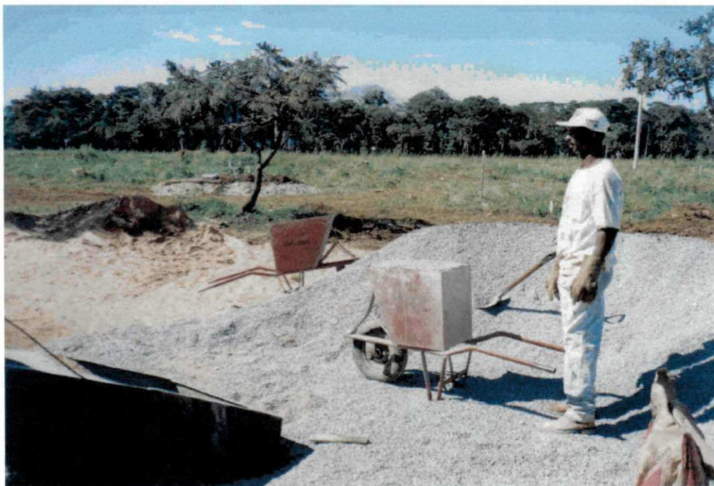
FIGURA 11 – Depósito de agregados e padiolas volumétricas metálicas
