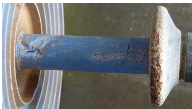
Figura 9 - Erosão em isolador polimérico.
