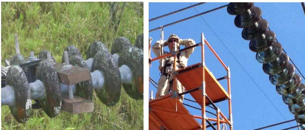
Figura 3.1. Isoladores de vidro temperado cobertos por poluição biológica na região sul da Bahia: (a) estrutura de ancoragem na cidade de Ibirataia-BA; (b) cadeia de isoladores no barramento da SE Funil 230kV na cidade de Ubaitaba-BA
