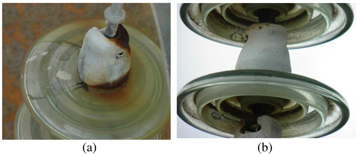
Figura 3.5. Isoladores de vidro temperado em cadeia de suspensão, linha de transmissão de 500kV na cidade de Glória - BA (a) vista superior com marca da descarga sofrida por poluição (b) vista inferior com marca de descarga sofrida por poluição
