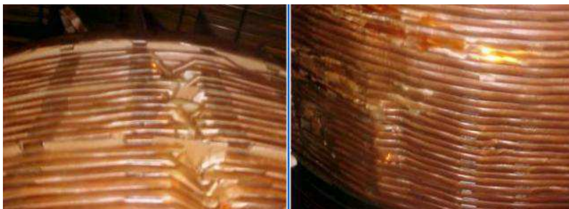
Figura 2– Deformações e danos na isolamento causados pela passagem de corrente de curtos circuitos.
