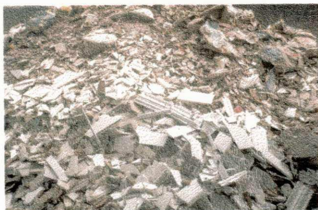
FIGURA 4.41- Entulho abandonado na própria construção
