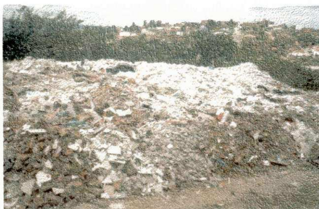
FIGURA 4.42- Deposição de entulho clandestino
