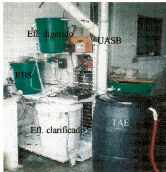
Figura 3.3 – Foto do sistema combinado UASB – RBS, destacando-se o tanque de armazenamento de esgoto peneirado (TAE), o reator UASB, os tanques de armazenamento do efluente digerido e clarificado e o reator aerado (RBS).
