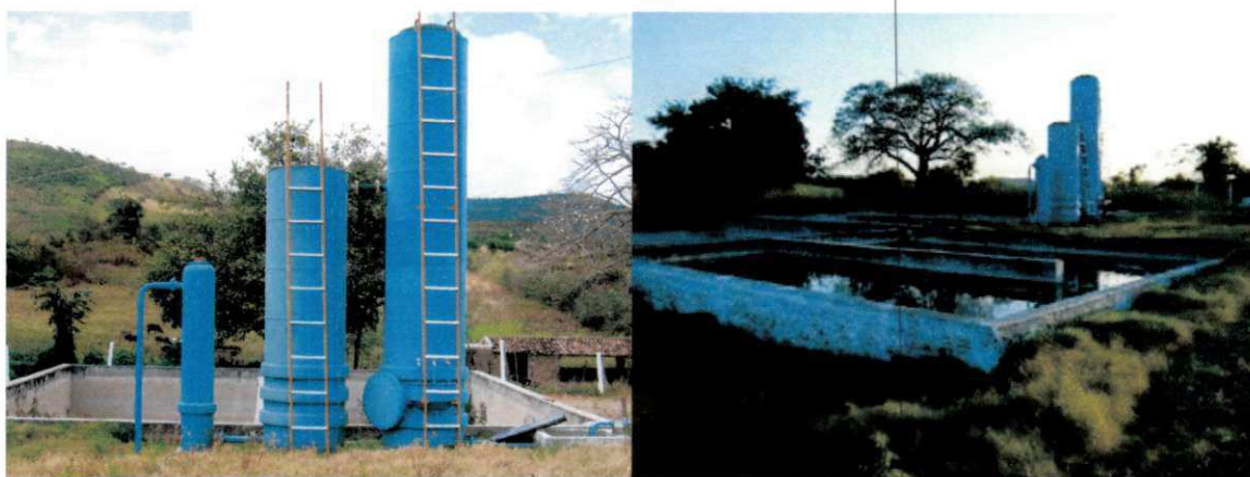
Figura 3.3 – Estação de tratamento de esgoto (ETE-MUTUCA)
