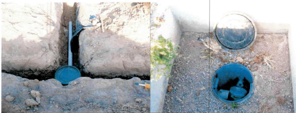
Figura 3.11 – Poço de visita
