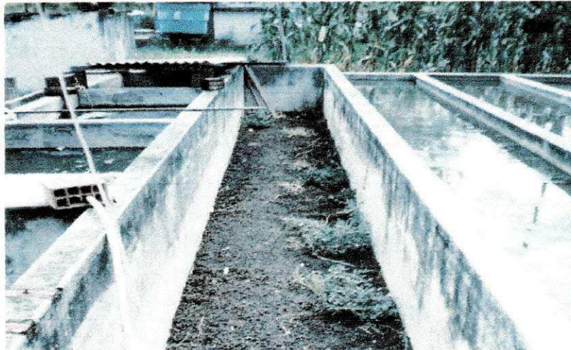
Figura 2. Desidratação do lodo de esgoto em leito de secagem.
