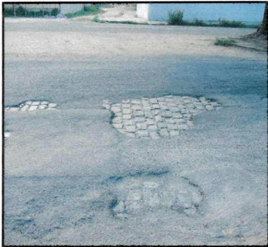
Figura S97- Falta de aderência entre o asfalto e a superfície do paralelepípedo [Local: Av. Elpidio de Almeida, Campina Grande-PB]
