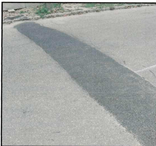
Figura R60 - Nível de severidade alto
