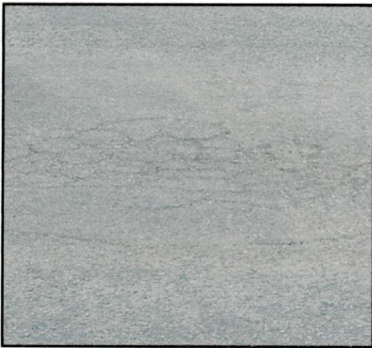
Figura R46 - Nível de severidade baixo
