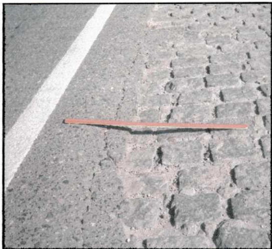
Figura S106 - Nivel de severidade baixo
