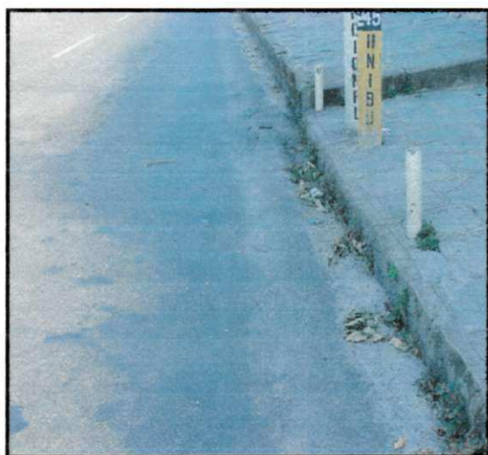
Figura S73 - Afundamento de trilha de roda [Local: Rua Vigário Calisto, Campina Grande-PB]
