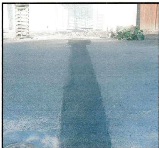
Figura R55 - Remendo formando "lombada" [Local: Rua Padre Anchieta Campina Grande-PB]
