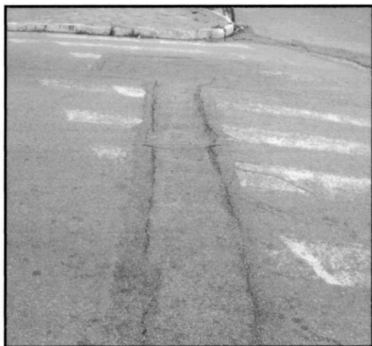
Figura R61 - Remendo com afundamento [Local: Rua Nilo Peçanha Campina Grande-PB]
