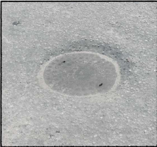
Figura D136 - Nível de severidade baixo
