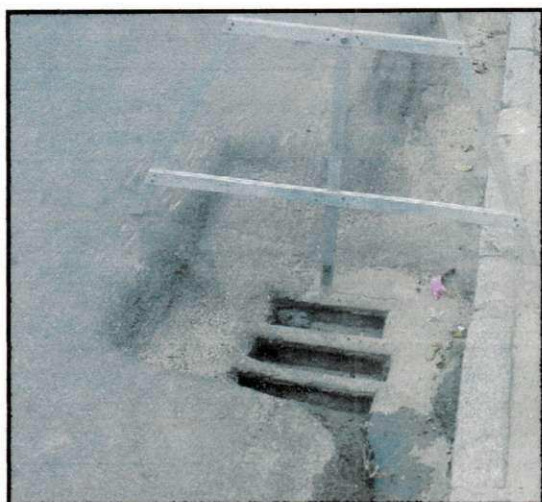
Figura D127 - Desnível da caixa coletora [Local: Avenida Giló Guedes, Campina Grande-PB]
