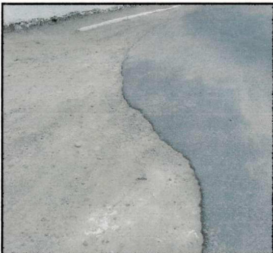
Figura S114 - Nivel de severidade alto
