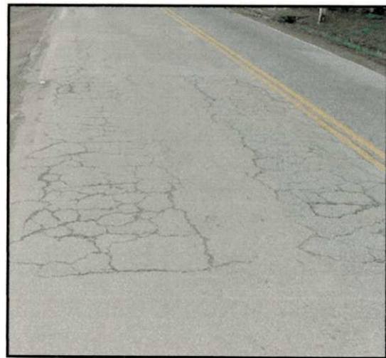
Figura R47 - Nível de severidade médio
