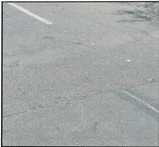
Figura R58 - Nível de severidade baixo
