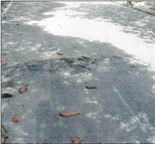
Figura S115 – Ruptura do revestimento por raízes de árvores.
