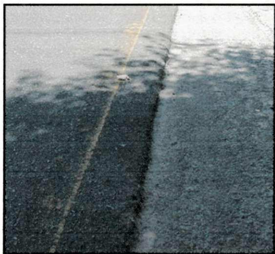
Figura S103 - Desnível acentuado entre a pista e o acostamento
