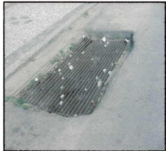
Figura D131 - Nivel de severidade médio
