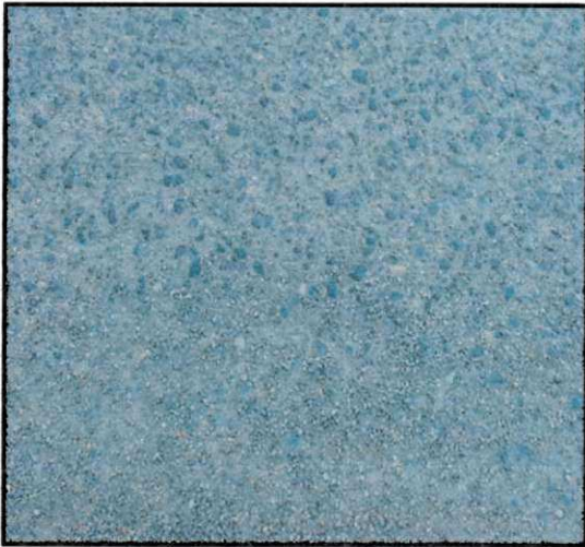
Figura S88 - Nível de severidade baixo
