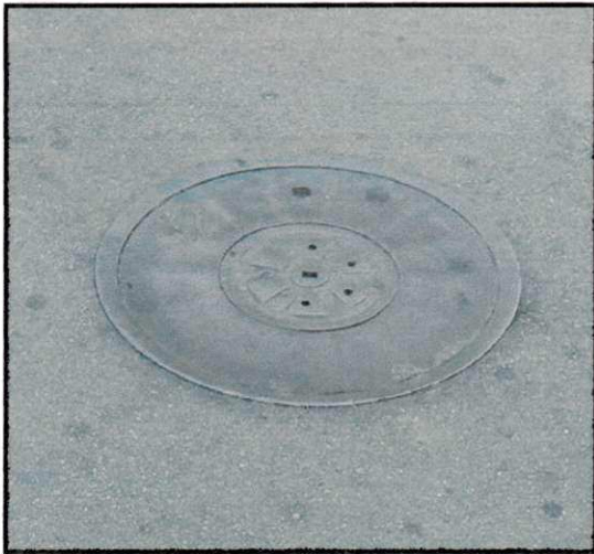
Figura D124 - Nivel de severidade baixo
