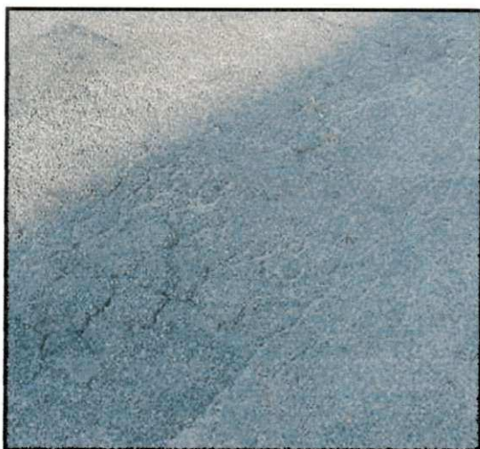
Figura S82 - Nível de severidade baixo
