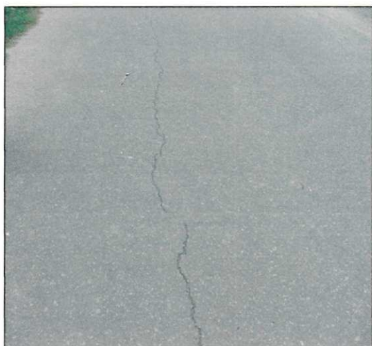
Figura T25 - Trincas longitudinais
