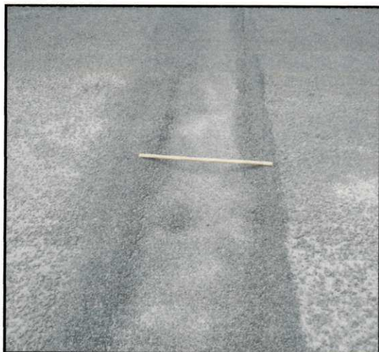
Figura R66 - Nível de severidade alto
