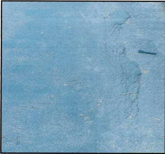
Figura R52 - Nível de severidade baixo
