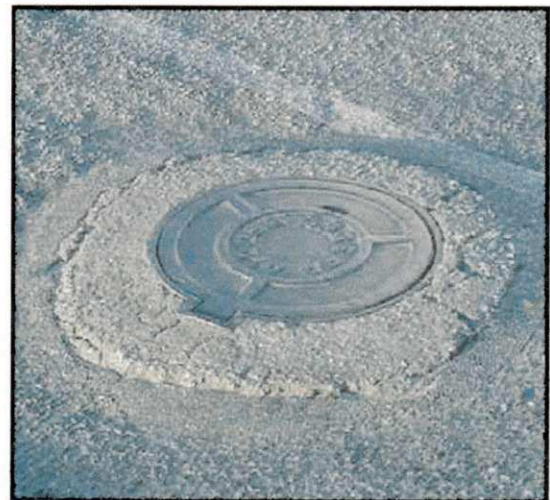
Figura D125 - Nivel de severidade médio
