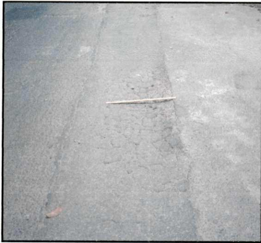
Figura R64 - Nível de severidade baixo
