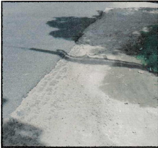
Figura S112 - Nivel de severidade baixo
