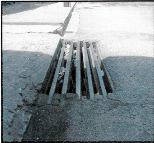
Figura D130 - Nivel de severidade baixo
