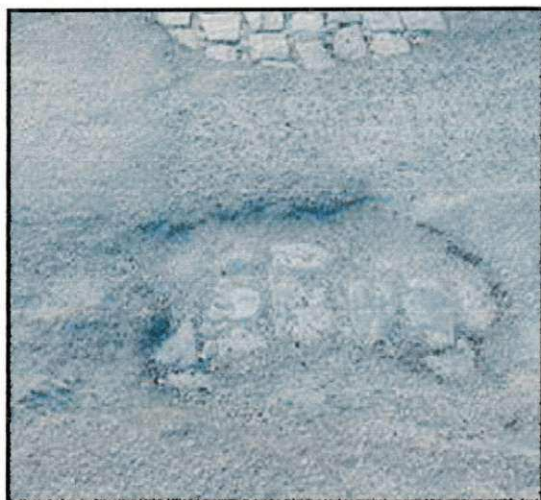
Figura S100 - Nivel de severidade baixo
