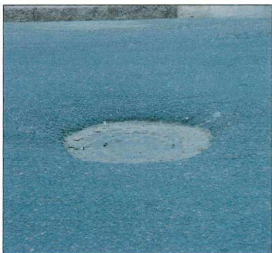
Figura 3.1 - Afundamento do tampão do poço de visita
