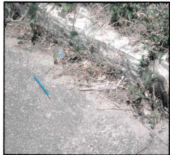
Figura D155 - Nivel de severidade médio
