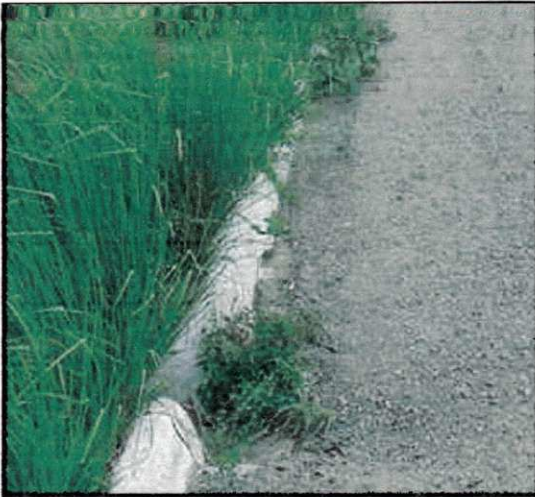
Figura D154 - Nivel de severidade baixo
