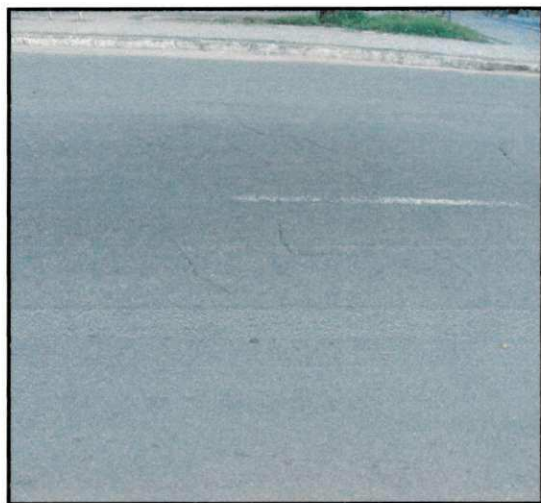
Figura T31 - Trincas transversais [Local: Av. Floriano Peixoto, Campina Grande-PB]
