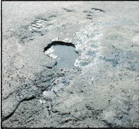
Figura D160 - Nível de severidade baixo
