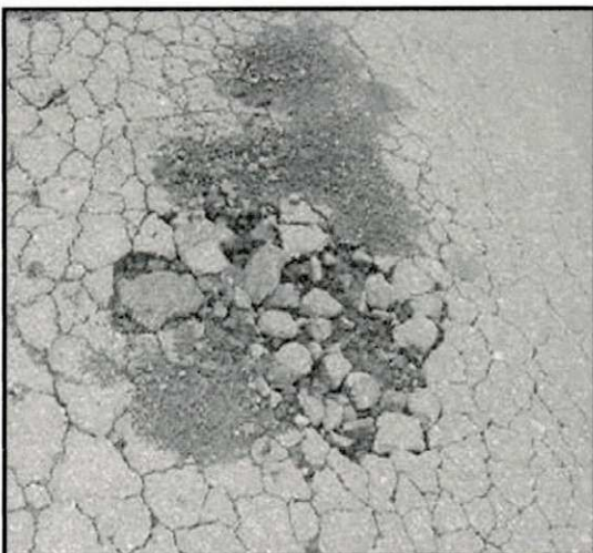
Figura T6 - Nivel de severidade alto
