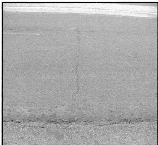
Figura T37 - Trincas por reflexão [Local: Av. Brasília, Campina Grande-PB]
