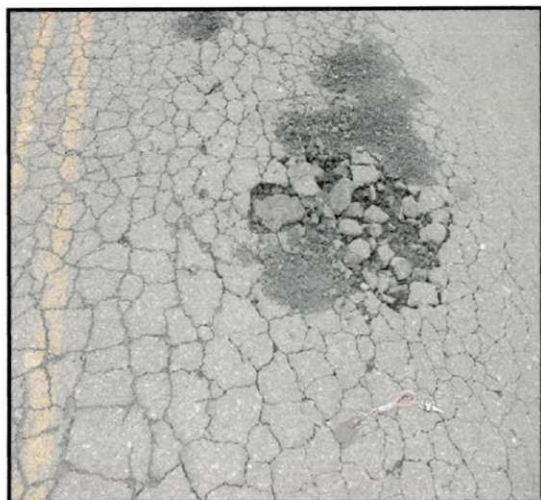
Figura T13 - Trincas couro-de-jacaré
