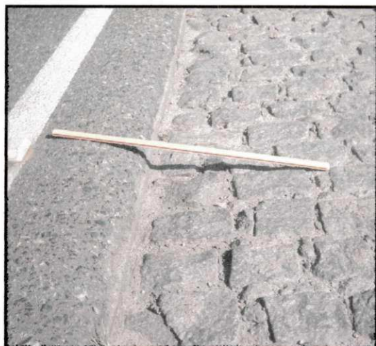
Figura S108 - Nivel de severidade alto
