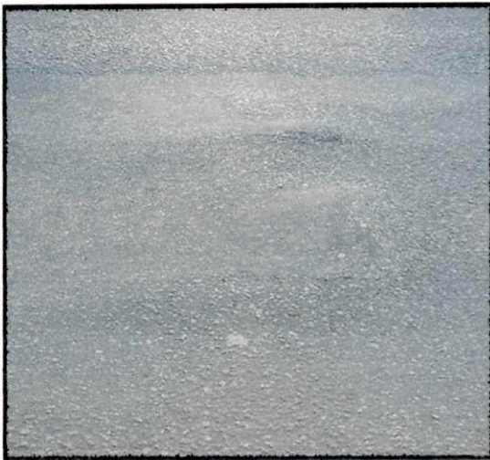
Figura S130 - Nivel de severidade baixo
