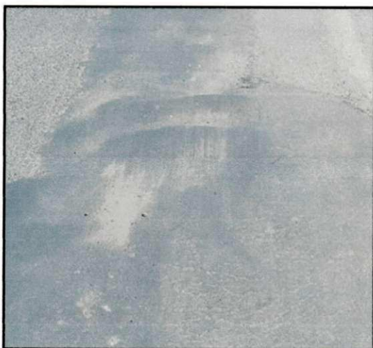
Figura R54 - Nível de severidade alto
