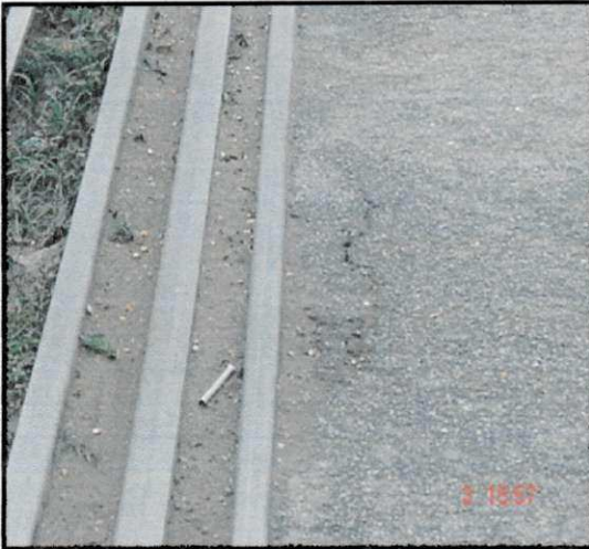
Figura S124 - Nível de severidade baixo
