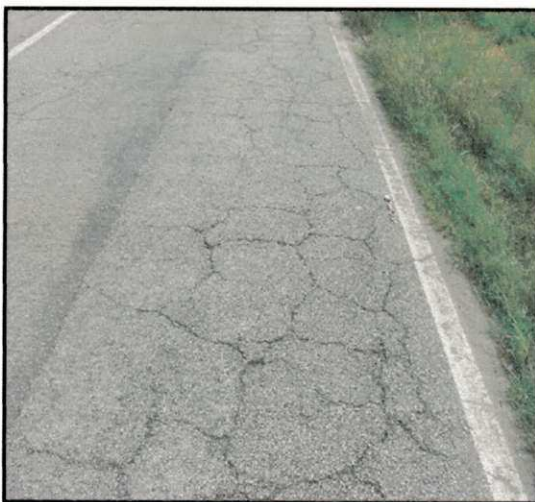
Figura R48 - Nível de severidade alto
