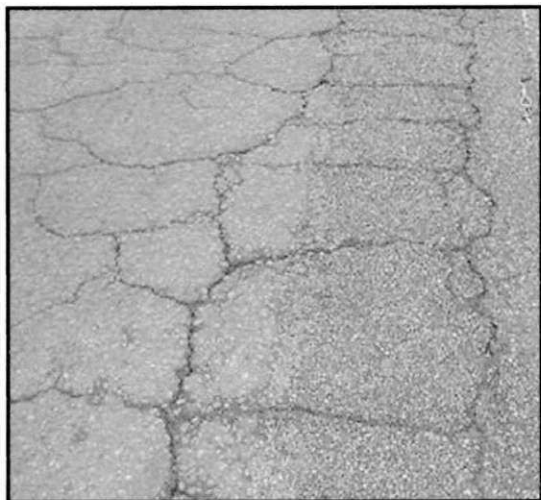
Figura T7 - Trincas em blocos
