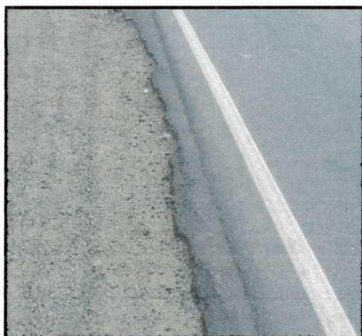
Figura S94 - Nível de severidade baixo
