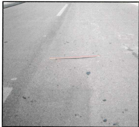
Figura S76 - Nível de severidade baixo
