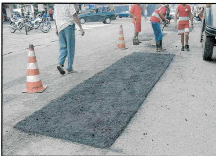
Figura 0-1.1 – Operações de tapa buracos em vias urbanas
