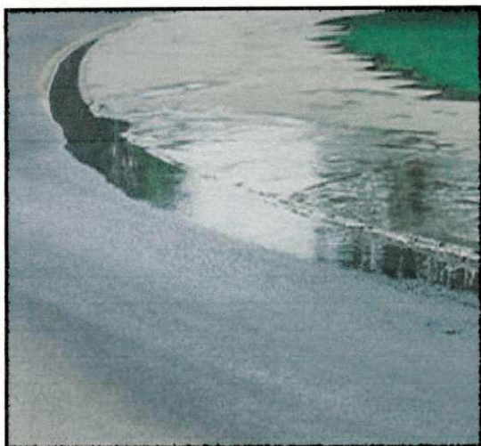
Figura D145 - Falta de equipamentos drenagem [Local: Rua Elpidio de Almeida, Campina Grande-PB]
