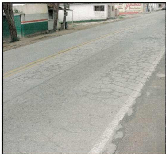
Figura R43 - Remendo com trincas em blocos
