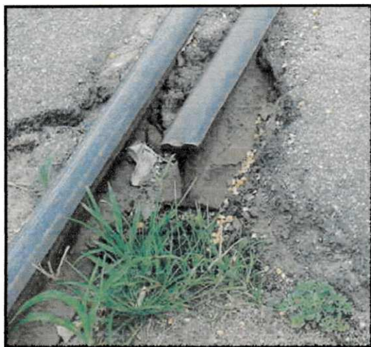
Figura S121 - Ruptura do revestimento nas proximidades de trilhos de ferrovias
