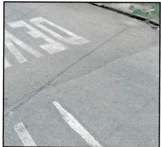
Figura R59 - Nível de severidade médio
