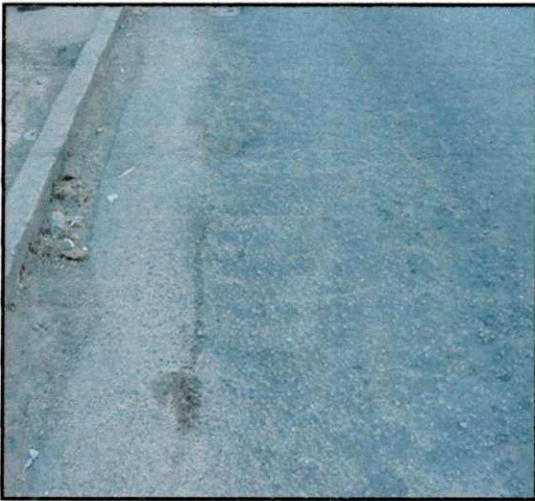
Figura S76 - Nível de severidade baixo
