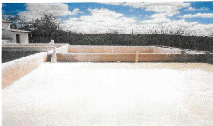
Figura 2.1 – Tanque de decantação
