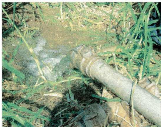
Figura 4.4 – Tubulação de saída da água do poço no sítio Riacho da Serra (São José do Sabugí/PB -16/12/05)
