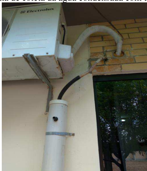
Figura 2 – Sistema de coleta da água condensada com tubos CCJS/UFCG
