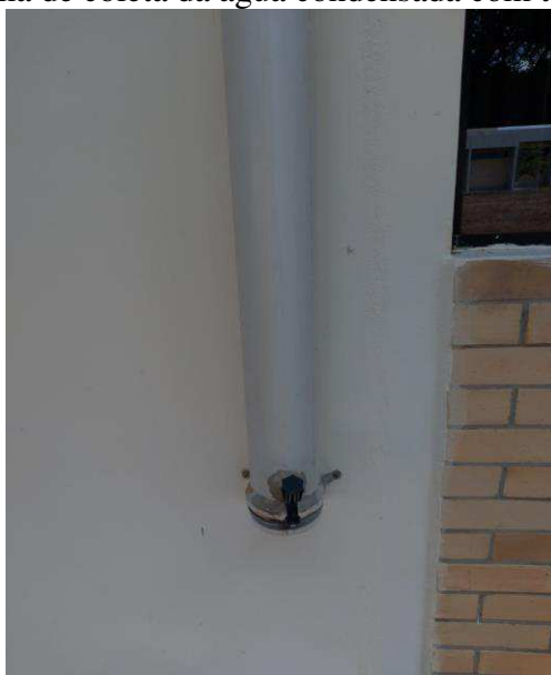
Figura 3 – Sistema de coleta da água condensada com tubos CCJS/UFCG
