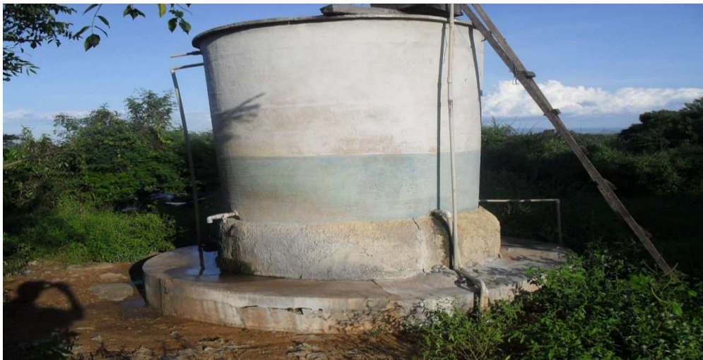
Foto 06 - Sistema de abastecimento de água canalizado público (Foto: Lidiane G. Dantas, 20/05/2011).
