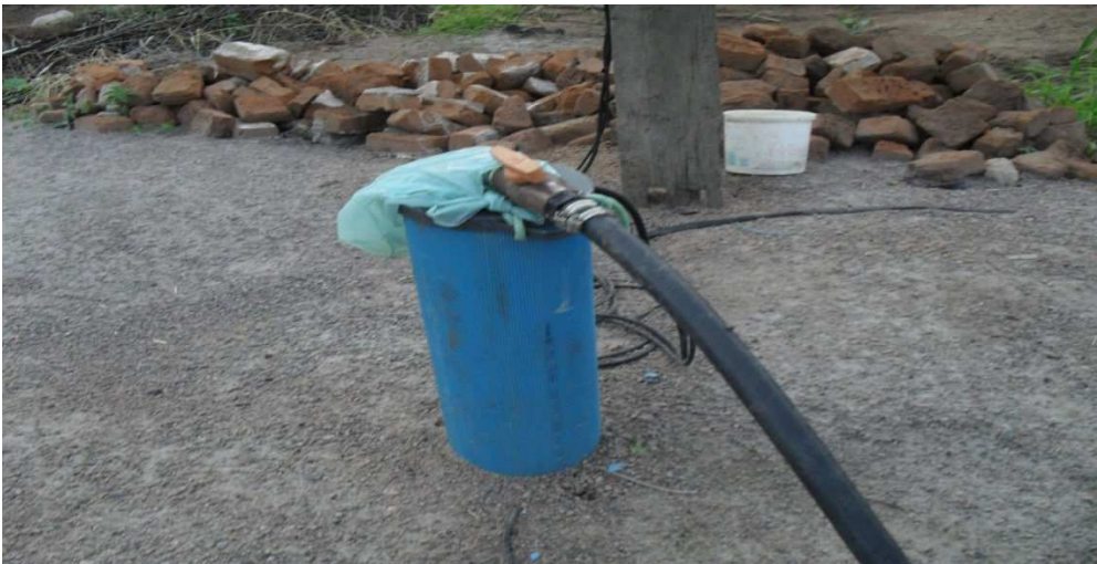
Foto 01 - Poço Tubular público, equipado com bomba elétrica (Lidiane G. Dantas. 20/05/2011).
