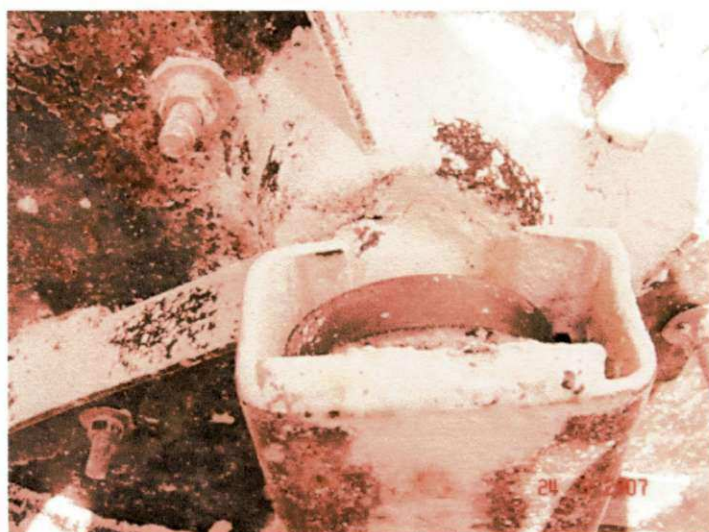
Figura 9 - Fotografia mostrando detalhe do rolamento do eixo principal do moinho.
