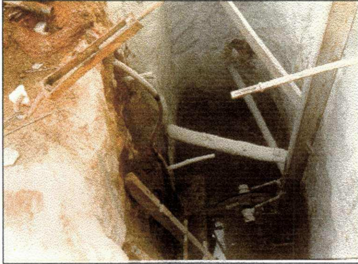
Foto 3.3- Vista de poço para instalação de desvio de fio helicoidal (roldana fixa), tendo ao fundo água para resfriamento e distribuição da polpa de granalha.
