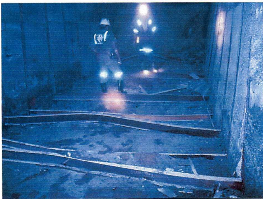
Fotografia 8 – Elevação do piso da galeria e flambagem nas cambotas
