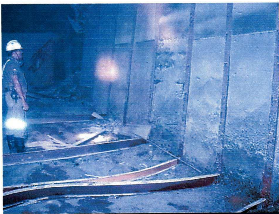
Fotografia 9 – Convergência das paredes
