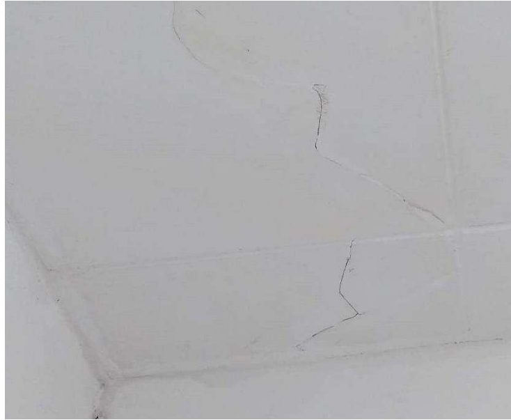
Figura 23 - Trincas no forro da Sala 6
