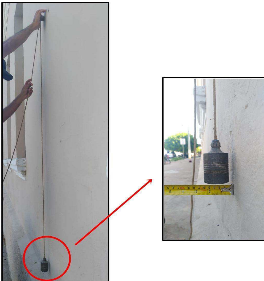
Figura 18 - Demonstração da inclinação da parede oeste
