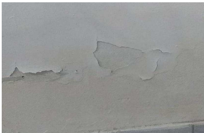
Figura 25 - Descolamento do revestimento pintura na Sala 6
