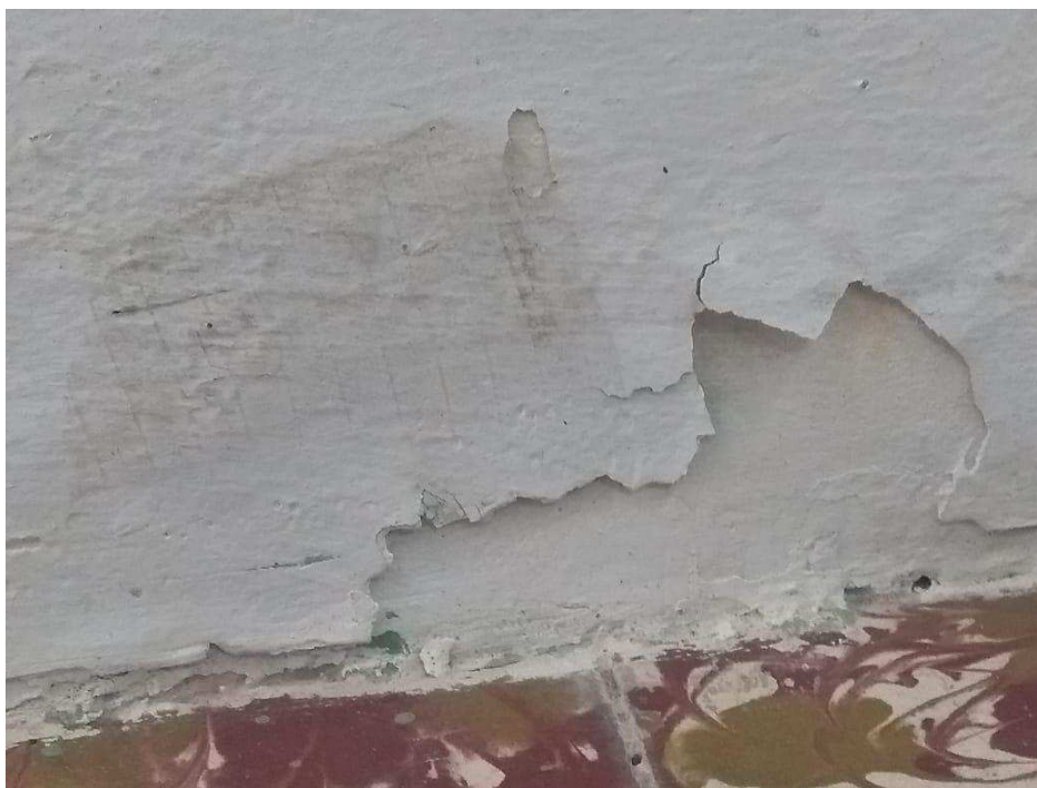
Figura 21 - Descolamento do revestimento pintura na Sala 5
