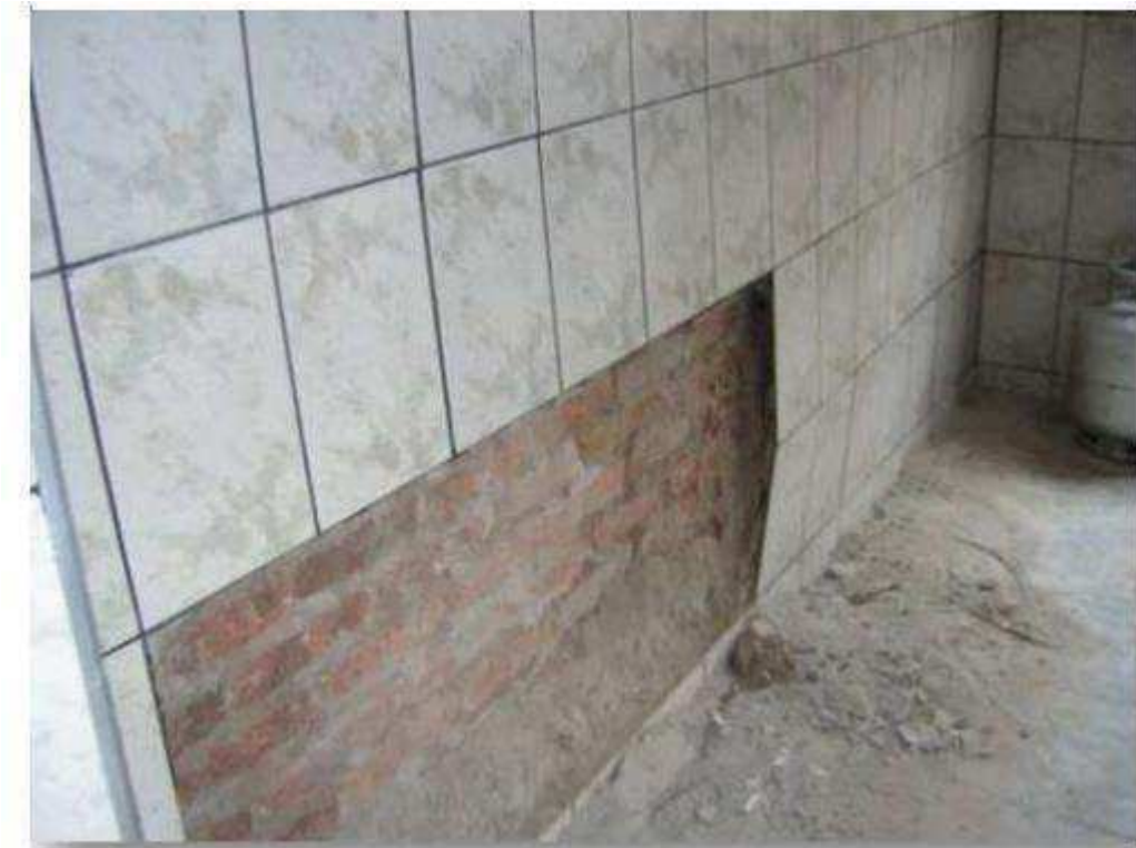
Figura 8 - Descolamento de Revestimentos
