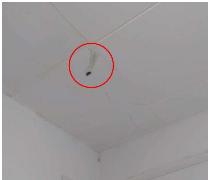
Figura 24 - Furo e sujeira no forro da Sala 6
