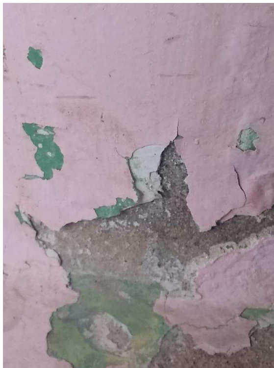
Figura 28 - Descolamento do revestimento pintura na Sala 7
