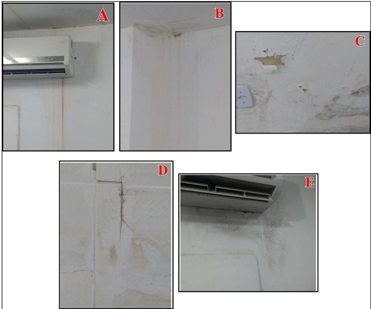
Figura 36 - Patologias do laboratório de computação
