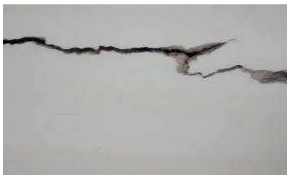
Figura 5 - Representação de uma Rachadura
