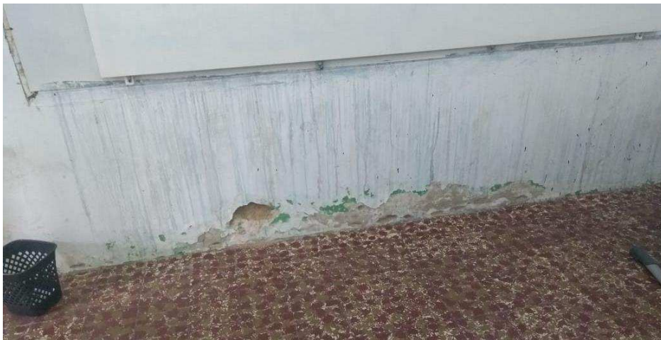
Figura 20 - Descolamento do revestimento e sujidade na Sala 4
