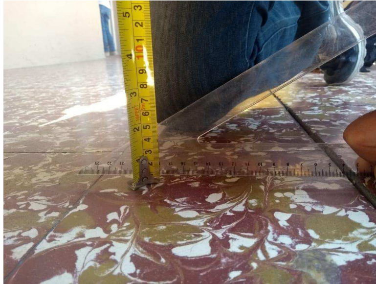
Figura 40 - Recalque do piso na Circulação
