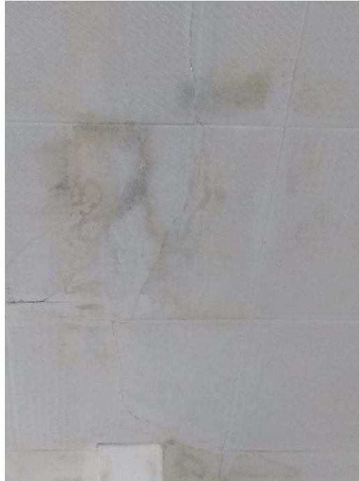
Figura 27 - Machas de umidade no forro da Sala 7
