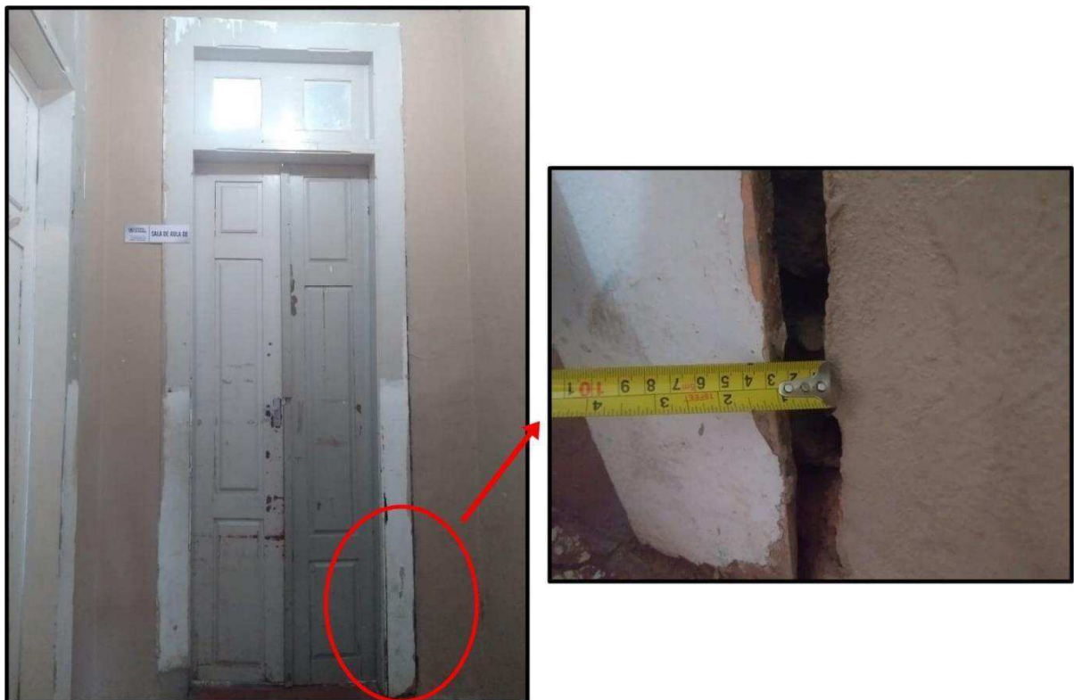
Figura 41 - Desprendimento do caixilho visto da Circulação
