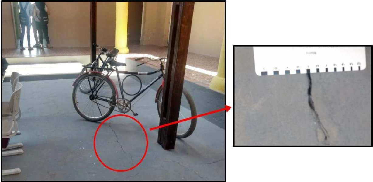
Figura 42 - Trincas na Circulação
