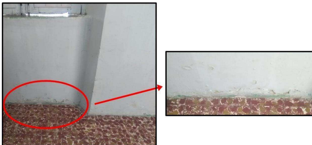
Figura 34 - Patologias na Sala dos professores
