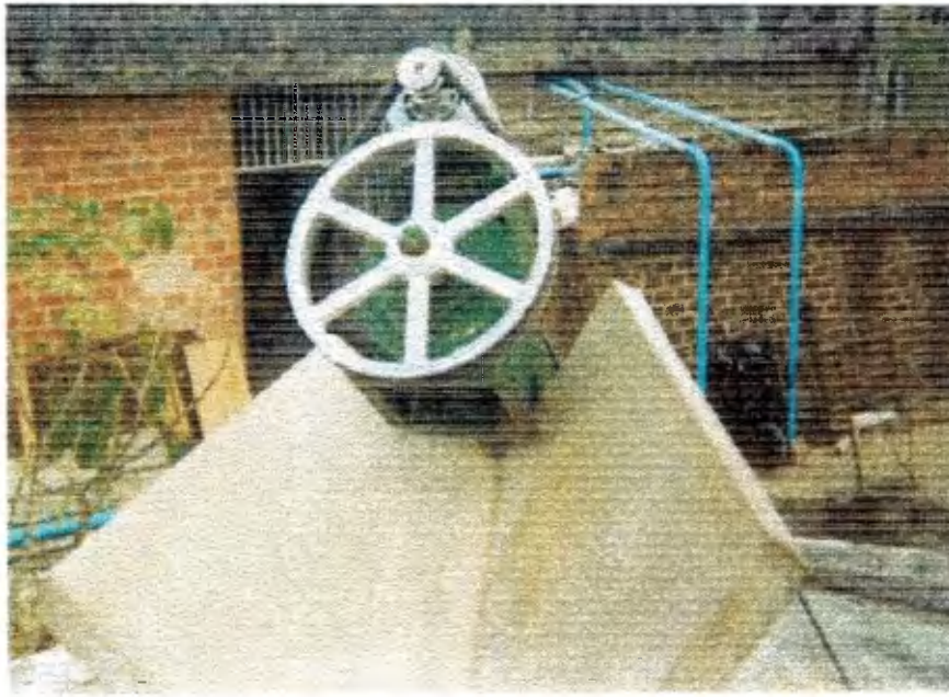
FIGURA 10 - Abertura da Rosca Transportadora por onde a areia é despejada.
