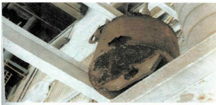
Fig. 04 – Exemplo de corrosão generalizada em um dinamômetro de sustentação das tubulações de condução de vapor de uma das caldeiras da Usina Termoeletrica de Piratininga.
