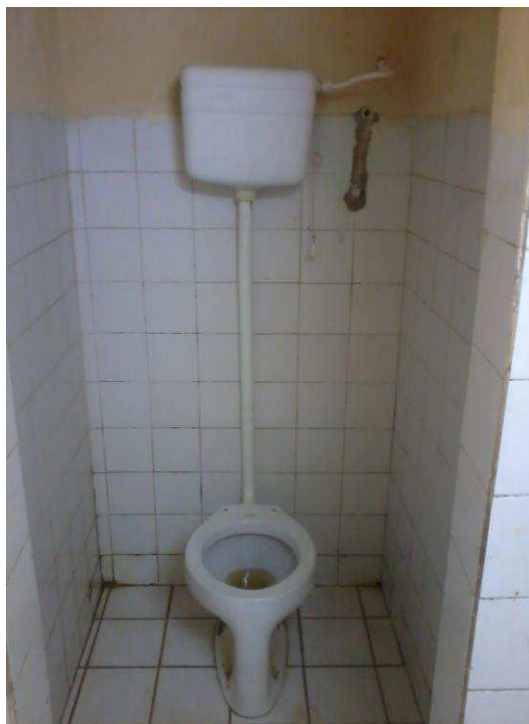
(Figura 18. Banheiro sem adaptações)
