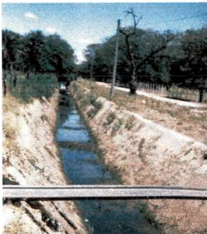
Figura 7. Vista do canal principal de distribuição de água do Perímetro Irrigado de São Gonçalo, com lâmina de água na altura disponível para irrigação da área experimental.
