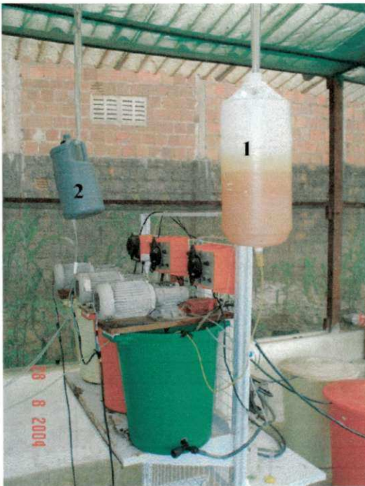
Figura 3.2 – Dosadores: (1) cloreto férrico e (2) sulfato de alumínio.
