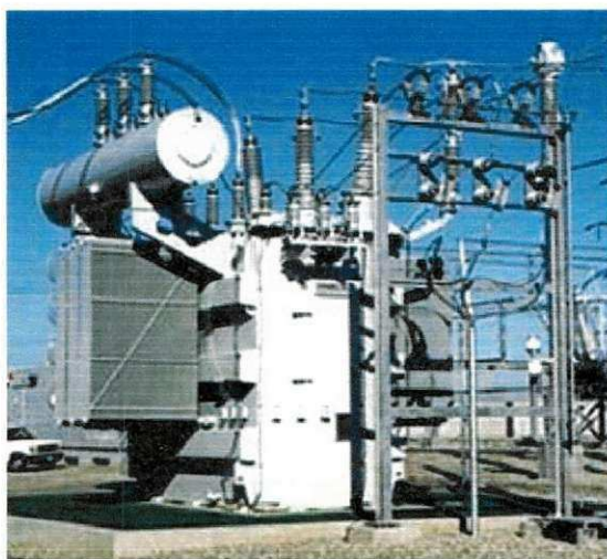
Figura I-15: Transformador em uma subestação
