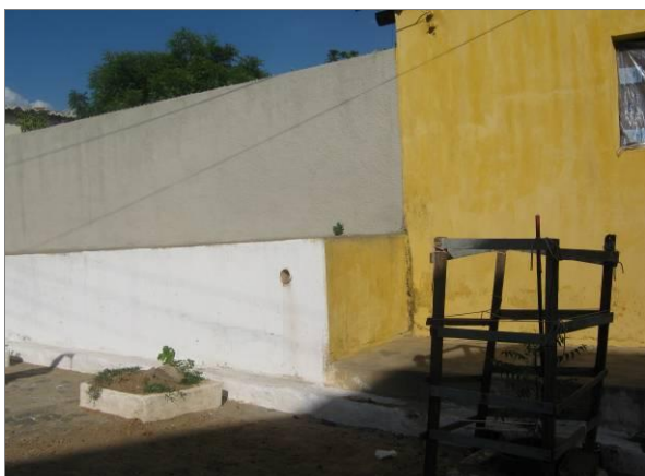
Figura 36– Calçada em desnível, Rua Basílio do Vale, Bairro São Sebastião, 10/04/2019.
