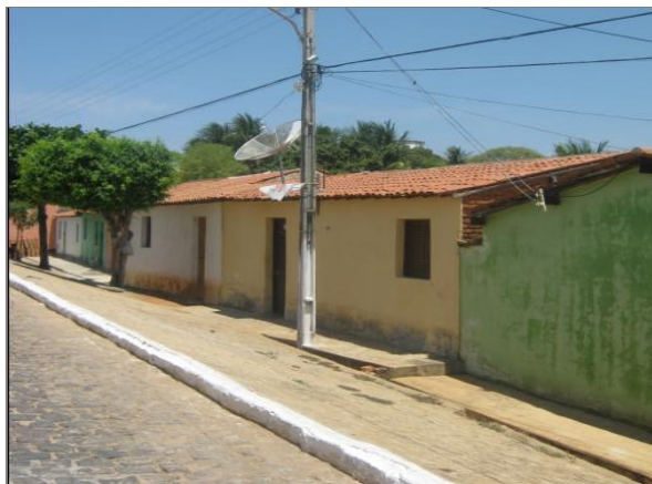
Figura 28–Calçada em desnível, Rua Francisco de Assis Mendes, Bairro Alto da Boa Vista, 10/04/2019
