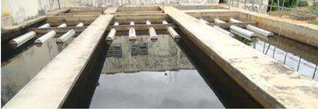
Figura 6- Decantadores retangulares ETA/Pombal
