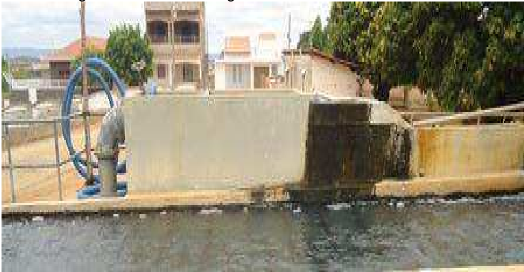
Figura 4- Entrada de água bruta na ETA/Pombal
