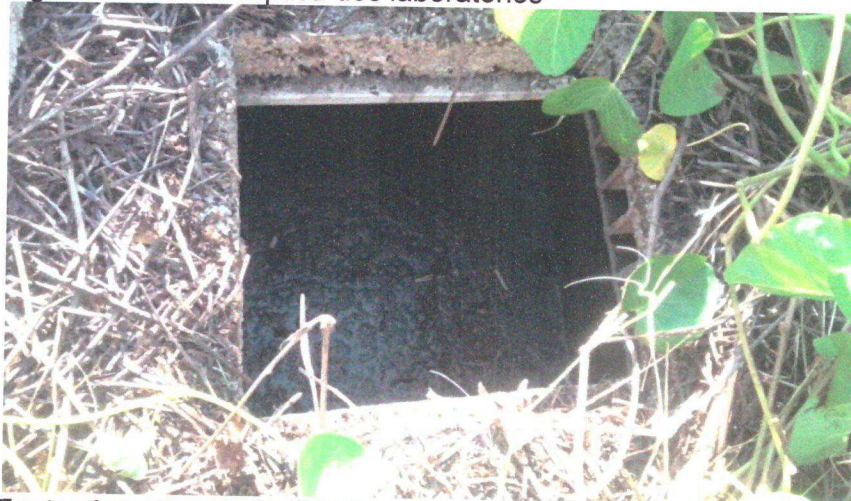
Figura 6 – Fossa séptica dos laboratórios
