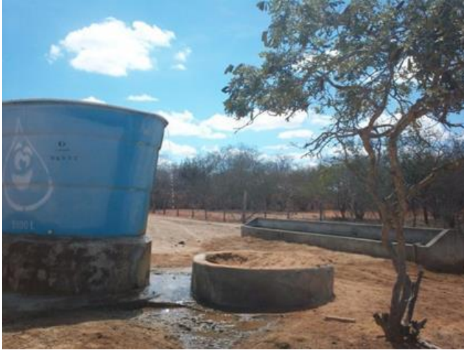
Figura 29. Água extravasando da caixa d'água.
