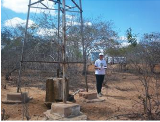
Figura 27. Corrosão na torre do cata-vento
