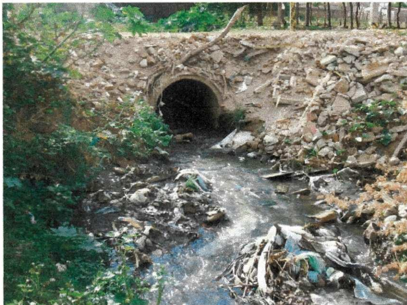
Foto 04: Descarte de esgotos do bairro Francisco Paulino para dentro do Rio Piancó.
