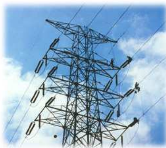
Figura 2.8: Torre de alta tensão
