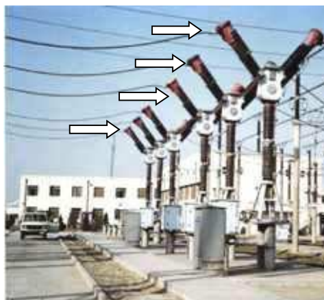
Figura 2.7: Disjuntores a gás
