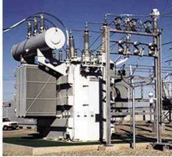
Figura 2.15: Transformador em uma subestação
