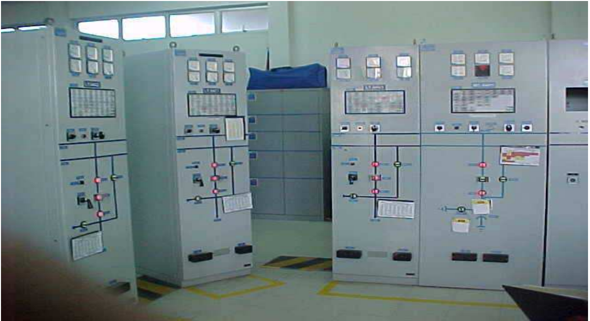
Figura 4.8: Painéis da Sala de Controle da subestação de Campina Grande II(CGD)
