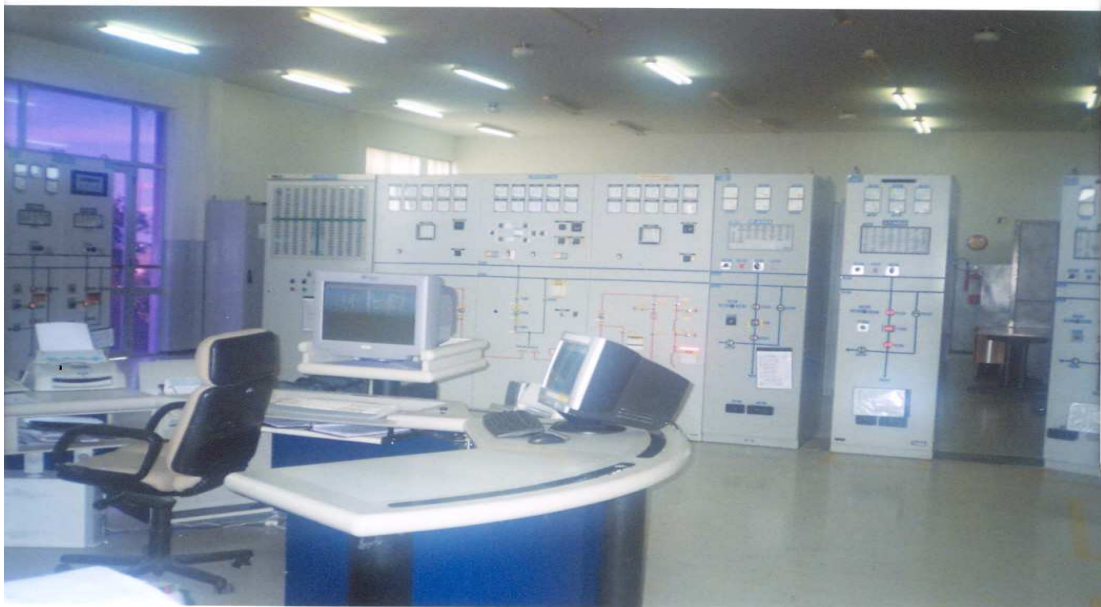
Figura 4.7: Sala de Controle da subestação de Campina Grande II (CGD)
