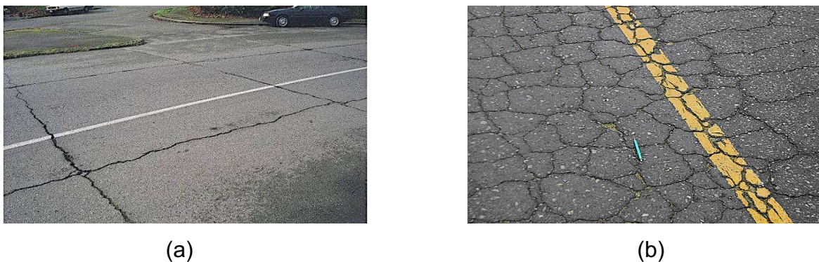
Figura 2. Trincas por fadiga em pavimentos asfálticos. a) trincas longitudinais, b) trinca do tipo “couro de crocodilo”.
