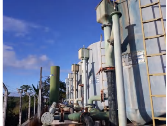
Figura 6 - Ilustra tubulações de entrada de água ETA e saída (Lavagens dos filtros)
