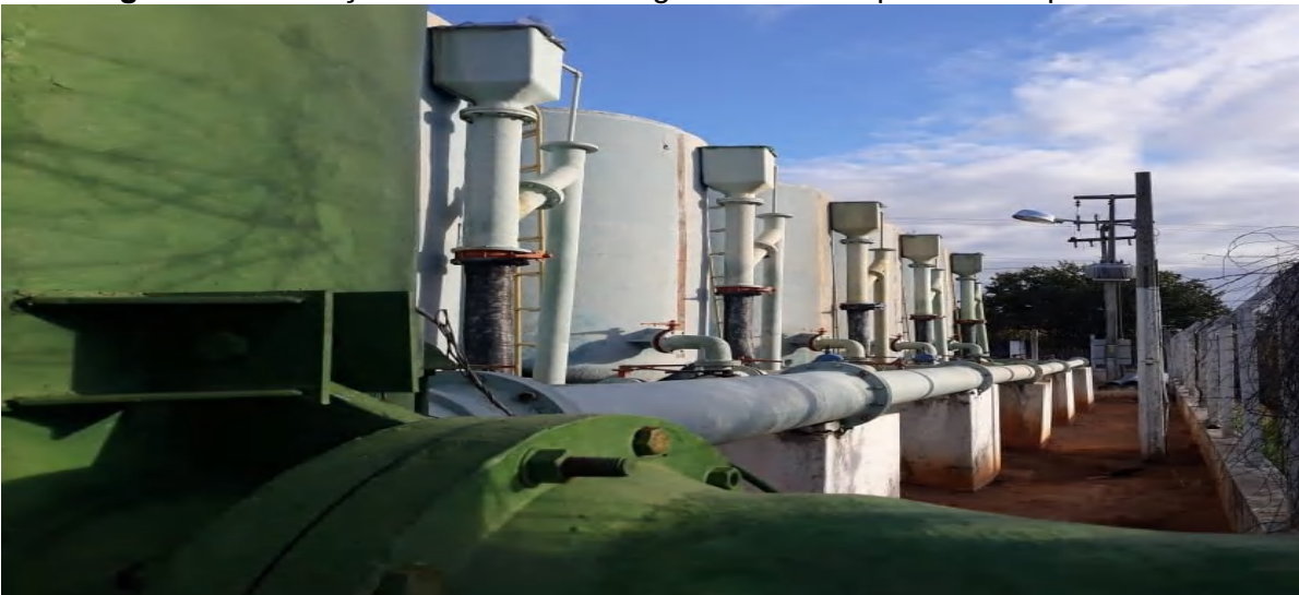
Figura 7 - Tubulação de saída das lavagens dos filtros para ETRG para ser tratado
