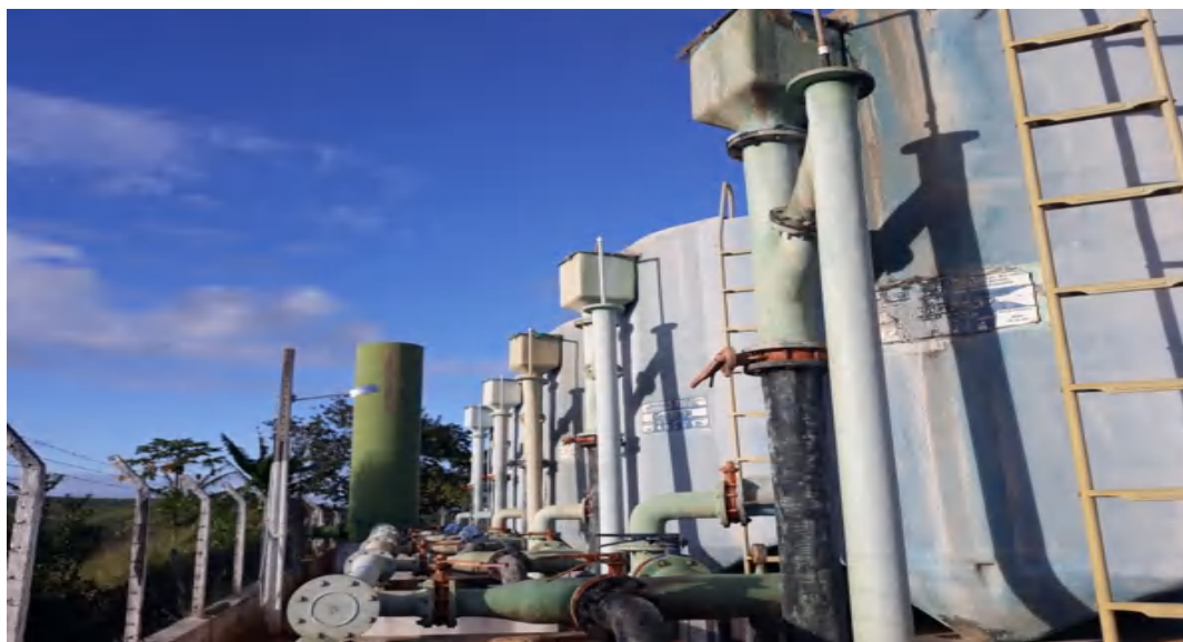
Figura 5 - Ilustra tubulações de entrada de água ETA e saída (Lavagens dos filtros)
