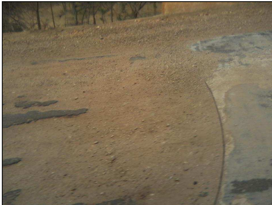
Figura 16 - Detalhe das Condições da Rodovia BA – 210 num Trecho Próximo ao AGRO Pedra Branca. Dezembro de 2012.
