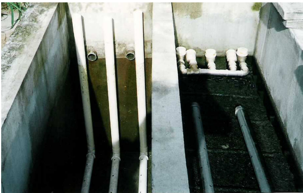
Figura 5.7 - Detalhes da ligação dos tubos de entrada e saída nos dois sentidos de fluxo. No filtro da esquerda, que está vazio, se vê os tubos de drenagem no fundo e as esperas dos tubos de entrada em cima, propiciando fluxo descendente. No filtro da direita, que está cheio, se vê os tubos de coleta na superfície e a ligação para alimentação através dos tubos de fundo, propiciando fluxo ascendente.
