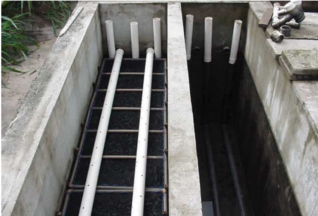
Figura 5.6- Detalhes dos tubos perfurados. No filtro da direita que está vazio, se vê os tubos de fundo, e no filtro da esquerda, que está cheio, se vê os tubos de distribuição na superfície.
