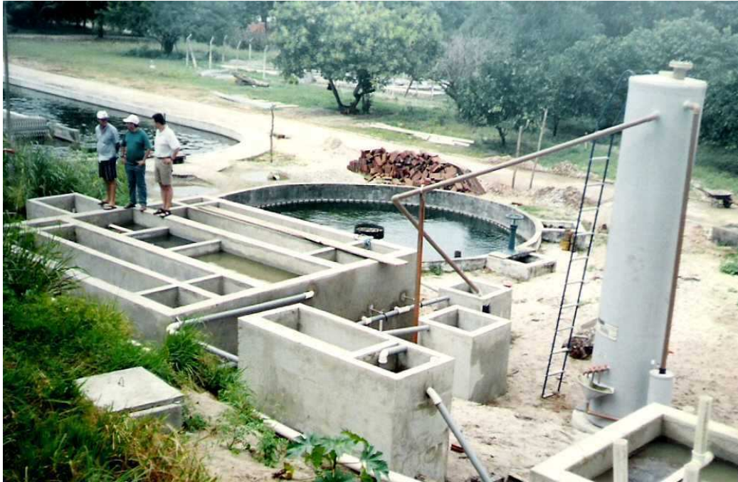
Figura 5.1- Vista geral do campo experimental na UFRN. O reator de manta de lodo à direita de quem olha e o decanto-digestor com os filtros anaeróbios à esquerda
