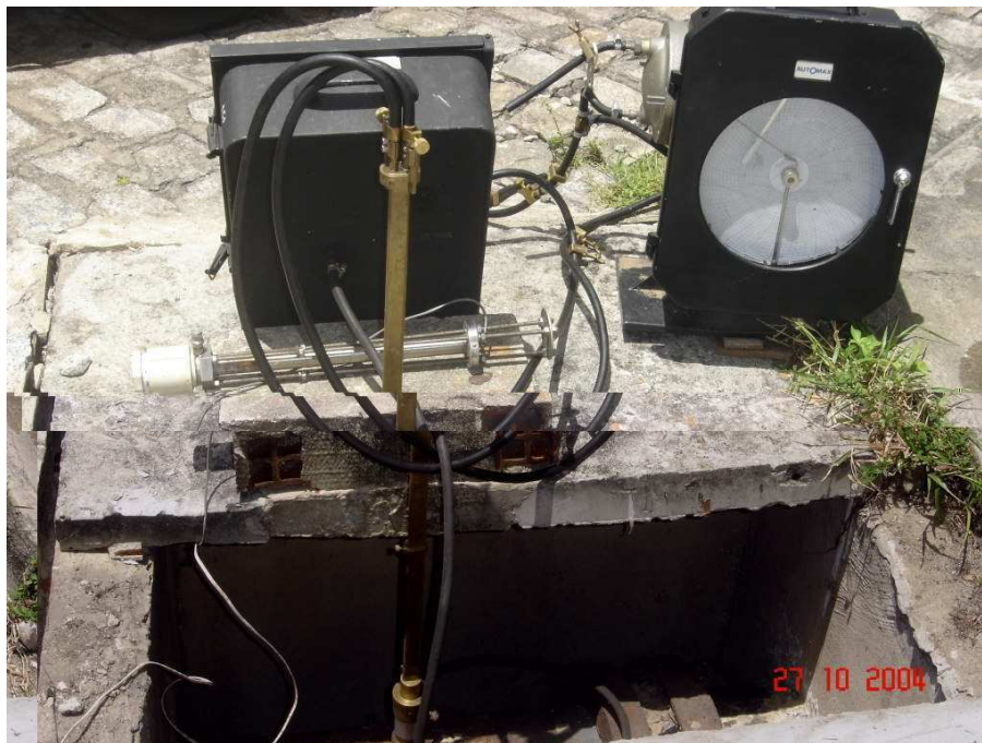
Figura 5.24 – Registrador de pressão e vazão no TAP.
