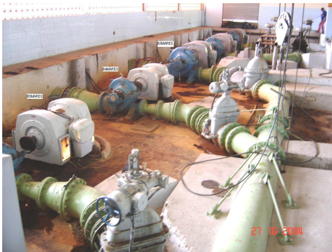
Figura 5.3 – Vista interior da elevatória Marés.
