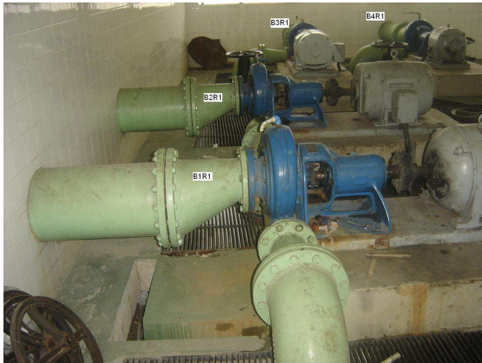
Figura 5.5 – Elevatória do Centro de Distribuição, R1.
