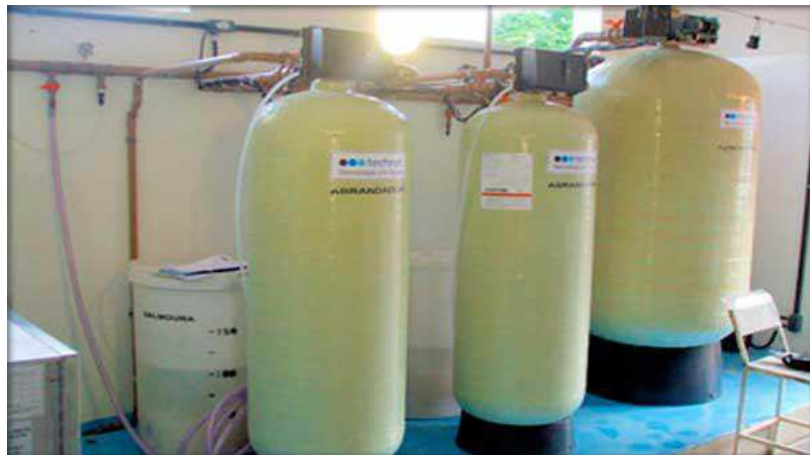
Figura 01 – Imagem externa dos filtros do pré-tratamento de água.
