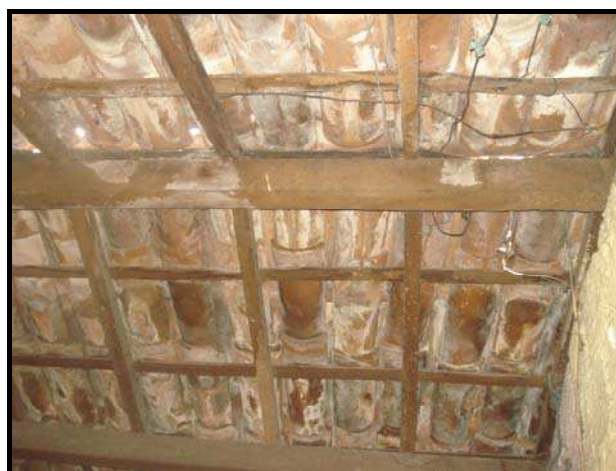
Figura 12 - Interior de uma residência (telhado) com presença de poeira advinda da fábrica e esporos de fungo.
