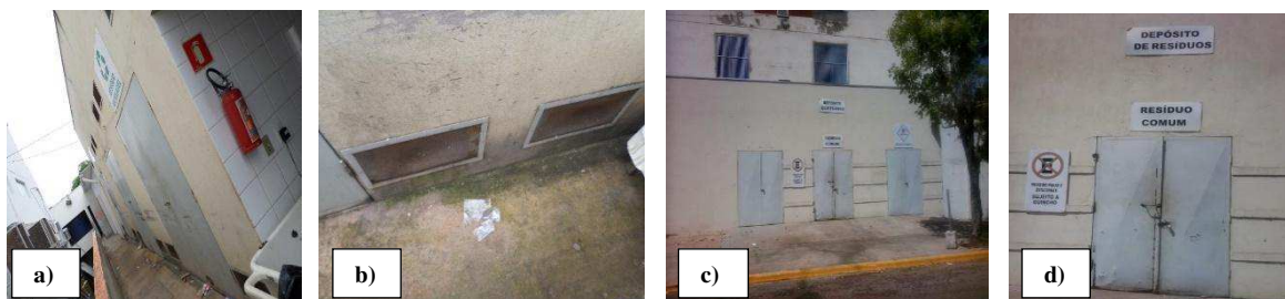
Figura 13: Depósito externo dos RSS: a) Acesso interno dos depósitos; b) Tela de proteção dos depósitos; c) Acesso externo do depósito; d) Porta externa de depósito de resíduos comum.
