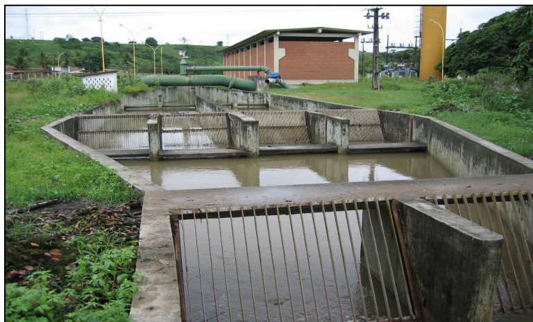
Figura 3.9 – Estação elevatória de água bruta para a ETA Gramame
