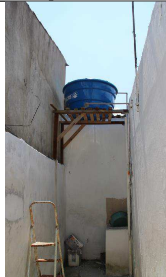
Média renda Aumento da capacidade de reservação (interligada à rede predial de distribuição)
