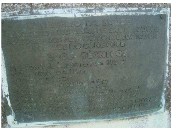
Fotografia 67. Placa da fossa Séptica no município do Congo sem manutenção há vários anos
