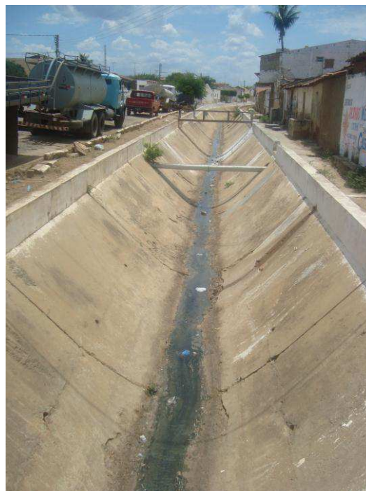
Fotografia 104. Canal de esgotos domésticos no município de Monteiro.
