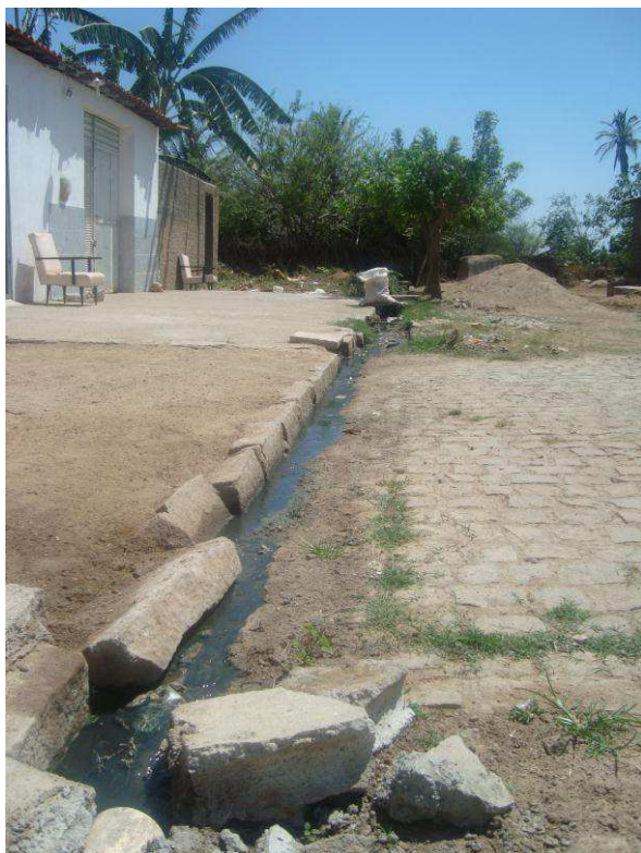
Fotografia 93. Esgoto doméstico a céu aberto no município de Prata
