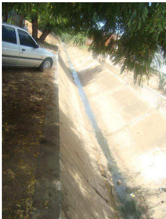
Fotografia 103. Canal de esgotos domésticos no município de Monteiro.
