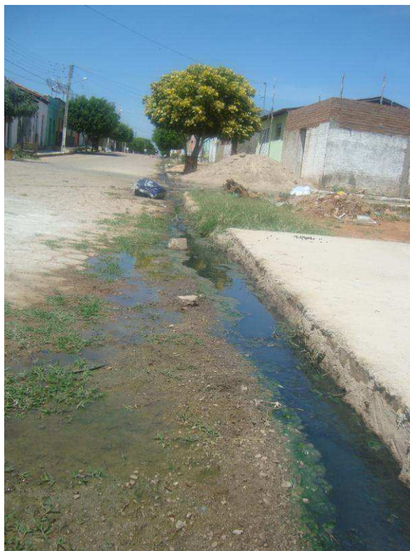
Fotografia 94. Esgoto doméstico a céu aberto no município de Prata
